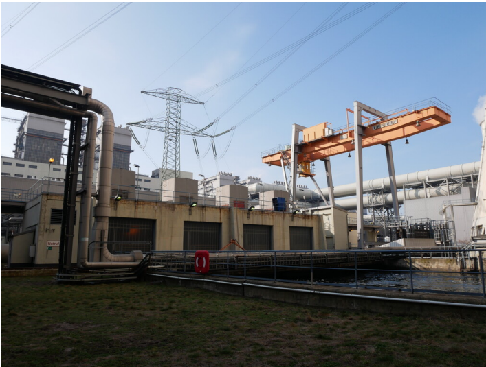
Kraftwerk Jämschwalde Kühlwasserpumpstation (2023) Fotograf/Urheber: Tanja Trittel
