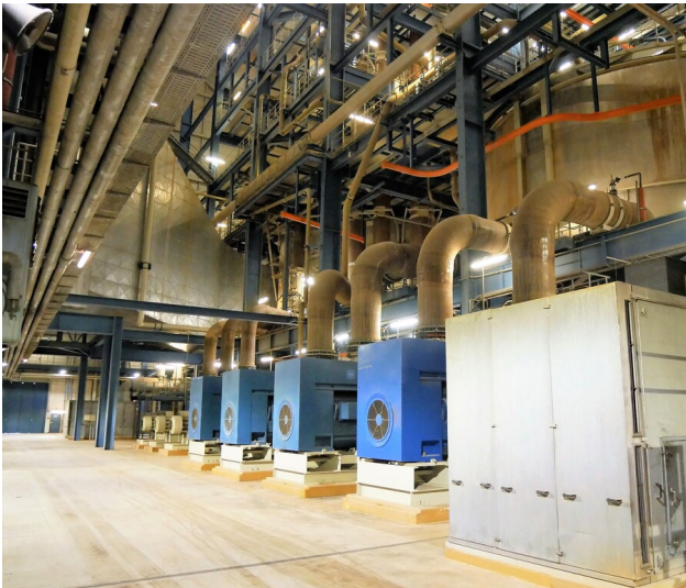
Rauchgasentschwefelungsanlage Fotograf/Urheber: Kaja Boelcke
