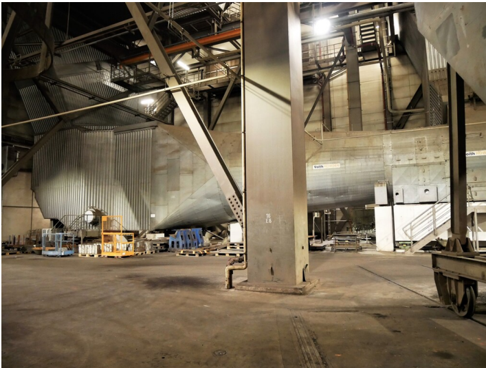
Luftvorwärmer Fotograf/Urheber: Kaja Boelcke
