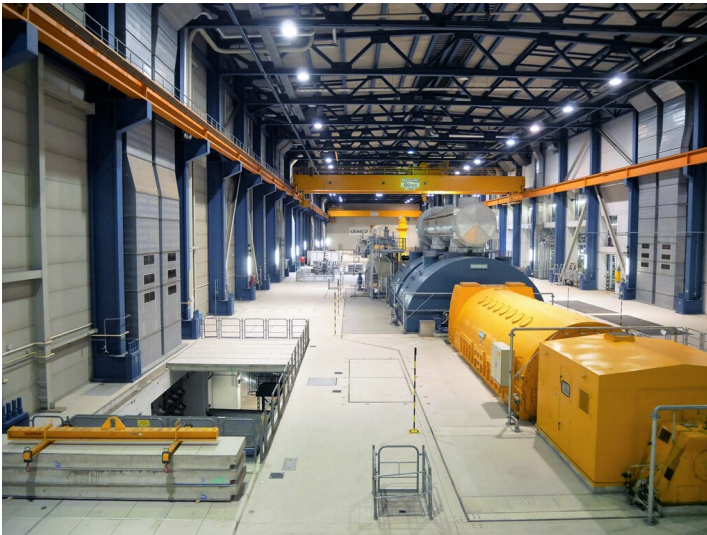
Dampfturbinen Fotograf/Urheber: Kaja Boelcke
