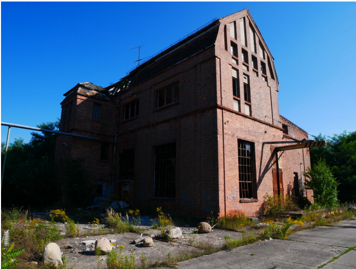
20-kV-Schaltheus Fotograf/Urheber: Franz Dietzmann
