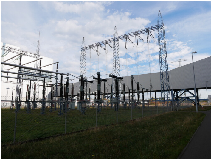
Freiluftschaltanlage Fotograf/Urheber: Kirsten Krepelin
