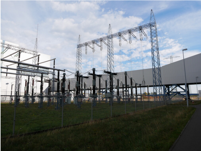
Freiluftschaltanlage Fotograf/Urheber: Kirsten Krepelin
