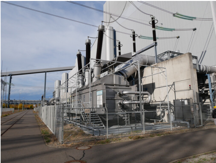
Transformatoren Fotograf/Urheber: Kirsten Krepelin
