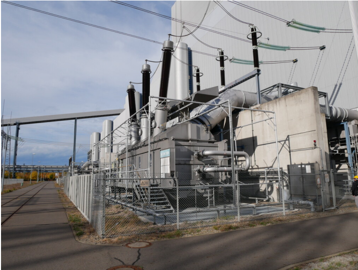
Transformatoren Fotograf/Urheber: Kirsten Krepelin
