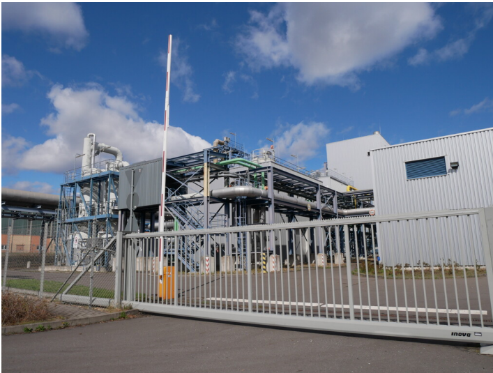
Oxyfuel-Forschungsanlage Fotograf/Urheber: Franz Dietzmann
