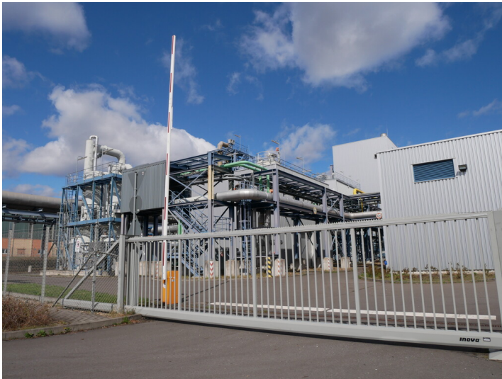
Oxyfuel-Forschungsanlage Fotograf/Urheber: Franz Dietzmann
