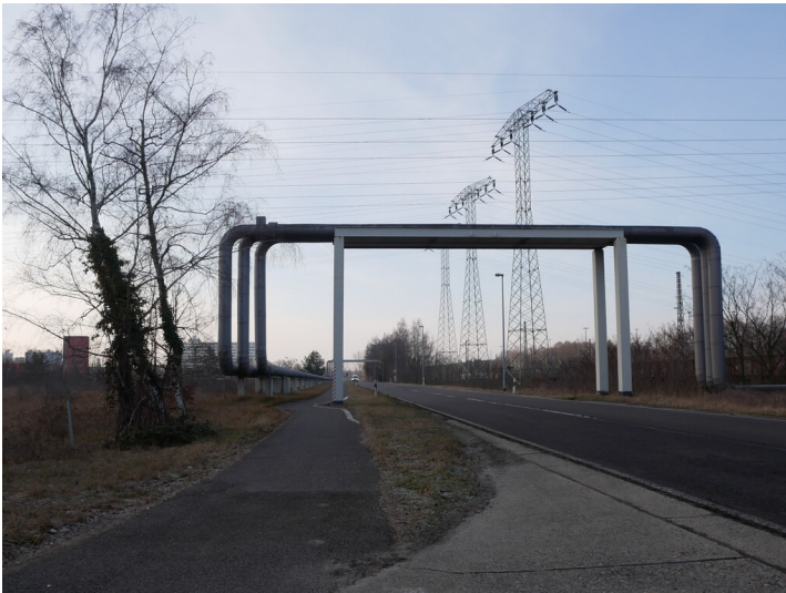
Kraftwerk Jänschwalde Fernwärmeversorgung (2023) Fotograf/Urheber: Tanja Trittel
