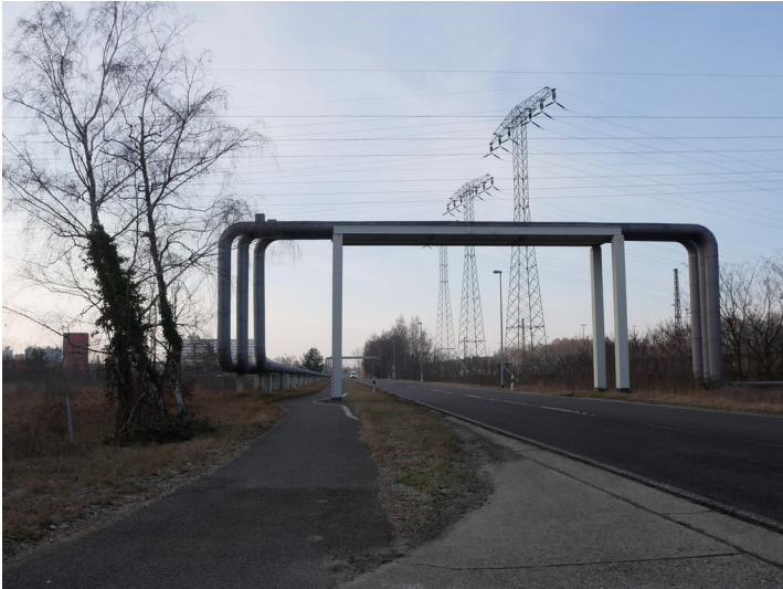
Kraftwerk Jänschwalde Fernwärmeversorgung (2023) Fotograf/Urheber: Tanja Trittel
