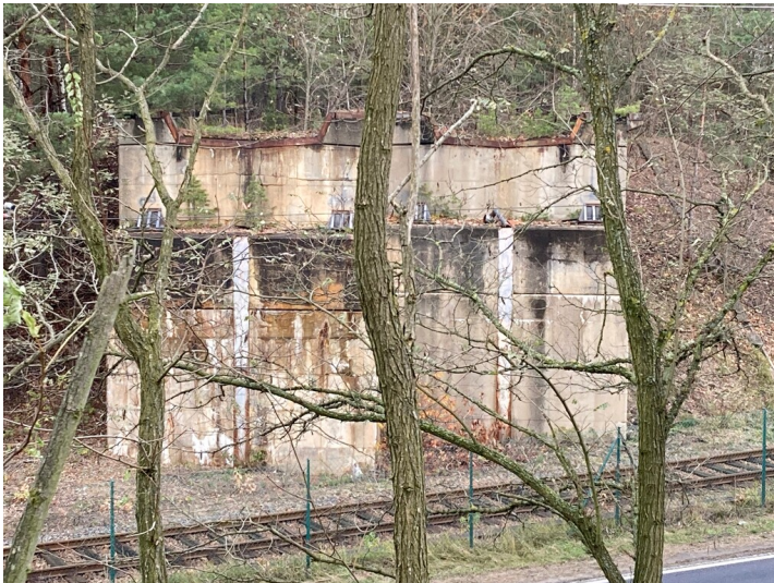
Ehemalige Kohlebahn Tagebau Bärwalde, Brückenwiderlager in der Nähe des Kraftwerkes Fotograf/Urheber: Tom Pfefferkorn
