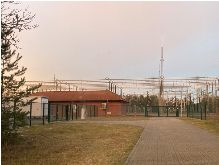
Umspannwerk und Schaltanlage Bärwalde Fotograf/Urheber: Matin Neubacher
