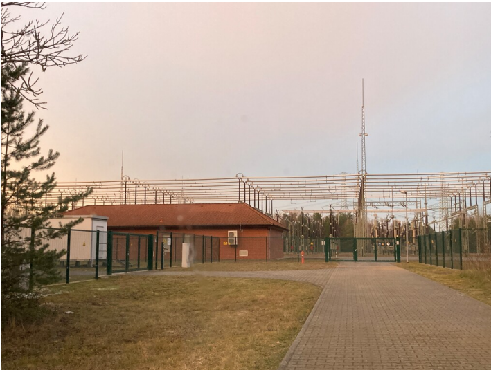
Umspannwerk und Schaltanlage Bärwalde Fotograf/Urheber: Matin Neubacher
