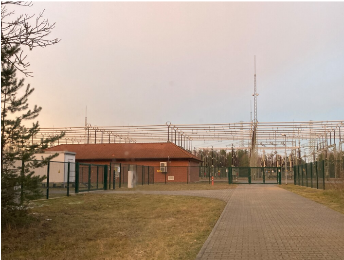
Umspannwerk und Schaltanlage Bärwalde Fotograf/Urheber: Matin Neubacher
