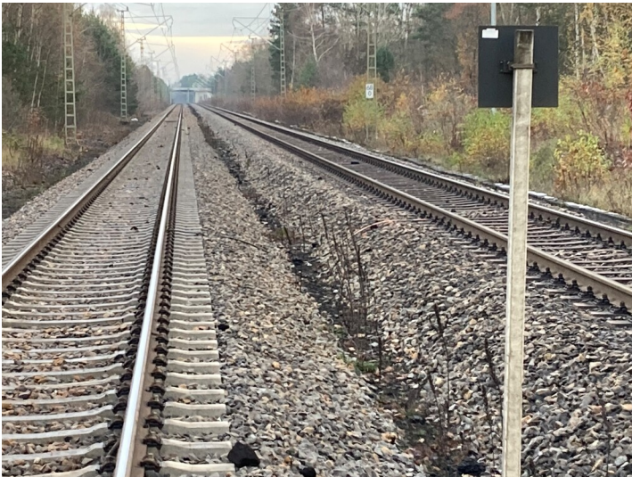
LGB Schwarze Pumpe - Boxberg, Strecke westlich des Kraftwerkes Fotograf/Urheber: Tom Pfefferkorn
