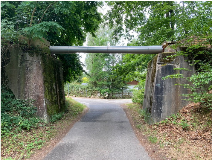
Frühere Werkbahn der Adolfschütte Quoos - Crosta, Widerlager der früheren Überführung bei Crosta Fotograf/Urheber: Tom Pfefferkorn
