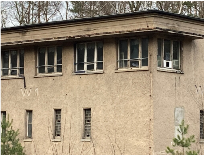
Strecke 6207 Roßlau - Horka Gr - Wegliniec (sächsischer Teil), ehemaliges Stellwerk am Bahnhof Knappenrode Fotograf/Urheber: Tom Pfefferkorn
