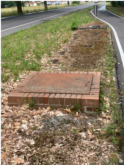
Brauchwasserleitung Knappensee-Zeißig-Kühnicht, Schacht an der Bautzener Straße Fotograf/Urheber: Tom Pfefferkorn
