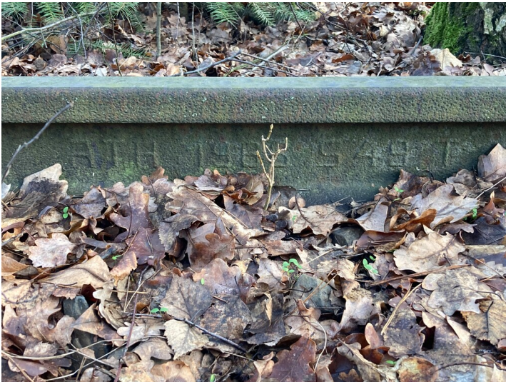
Anschlussgleis, ca. 1,5 km lang, vollständig erhaltener Bahndamm mit Oberbau, Walzzeichen Fotograf/Urheber: Tom Pfefferkorn
