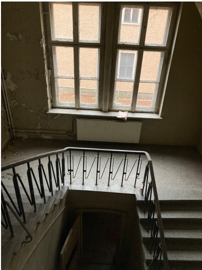
Im Kern Fabrikantenvilla der späten Gründerzeit von 1894, im Zweiten Weltkrieg beschädigt, Treppenhaus von 1954 Fotograf/Urheber: Tom Pfefferkorn
