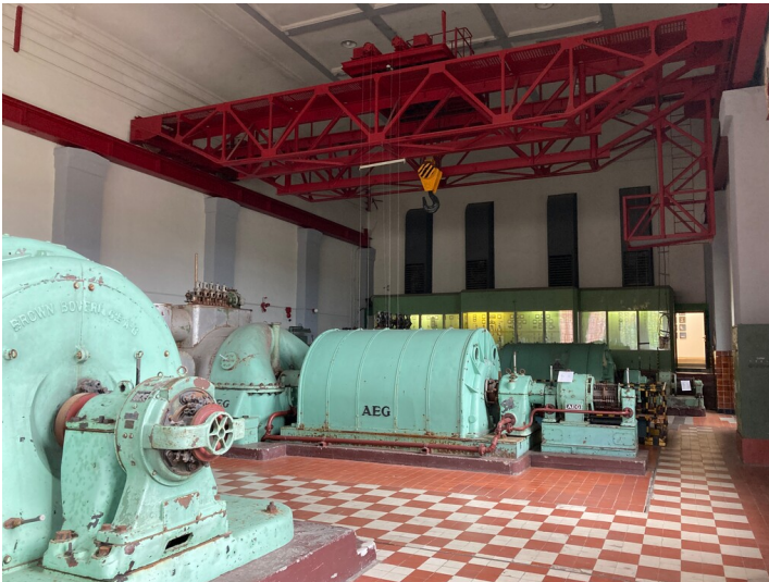
Brikettfabrik Werminghoff/ Knappenrode, Turbinenhaus, Innenansicht mit Turbine und Portalkran Fotograf/Urheber: Matin Neubacher
