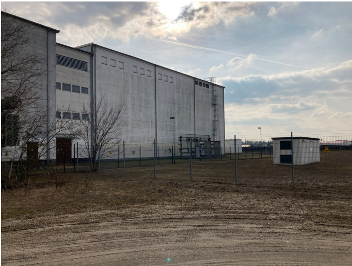
Umspannwerk des Lautawerks Fotograf/Urheber: Martin Neubacher
