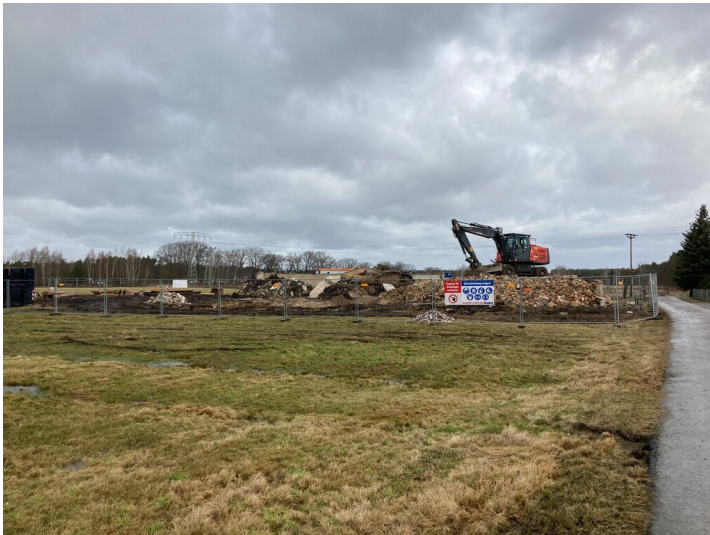
Reste eines Bauernhauses Mühlrose Fotograf/Urheber: Martin Neubacher
