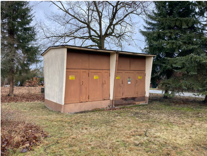
Transformatorstation Mühlrose Fotograf/Urheber: Martin Neubacher
