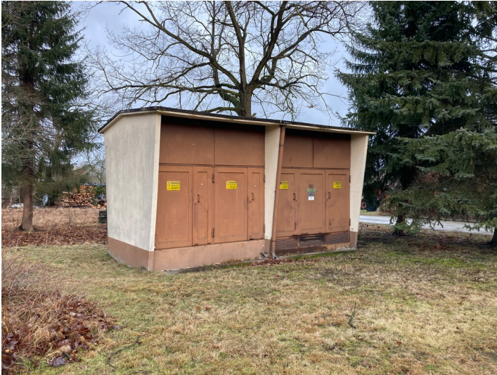
Transformatorstation Mühlrose Fotograf/Urheber: Martin Neubacher
