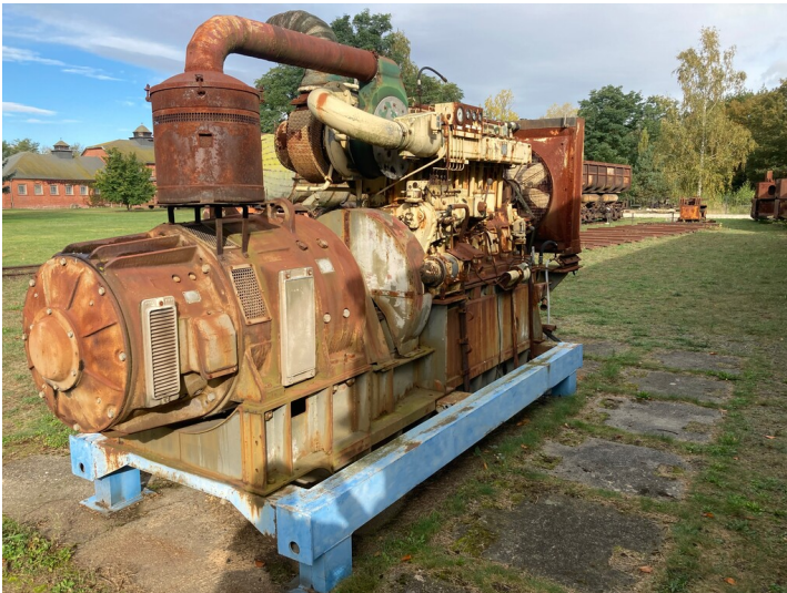
Technische Geräte der Brikettfabrik Knappenrode Fotograf/Urheber: Martin Neubacher
