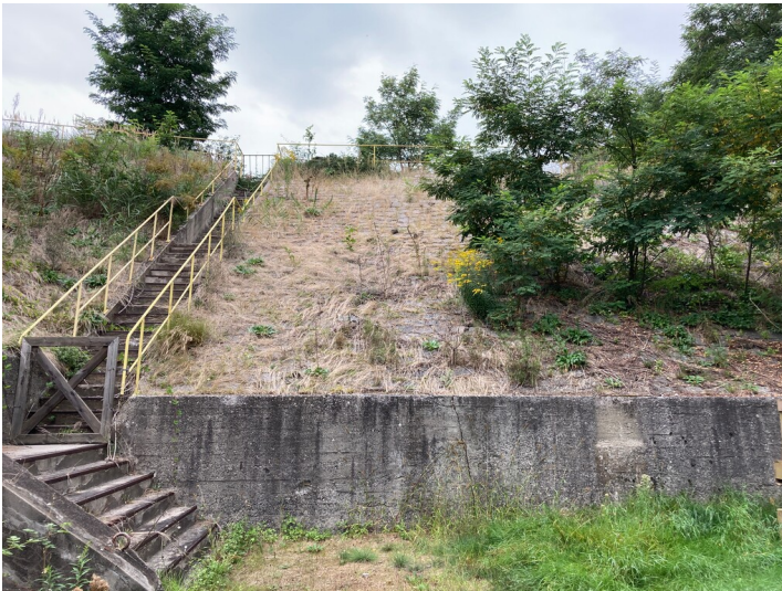
Böschungsmauer auf dem Gelände der Brikettfabrik Knappenrode Fotograf/Urheber: Martin Neubacher
