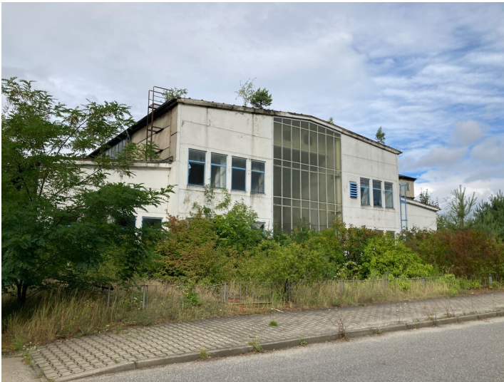
Ehemalige chemische Wasserreinigungsanlage am Altwerk Kraftwerk Boxberg, Ansicht von Osten Fotograf/Urheber: Kathrin Kruner
