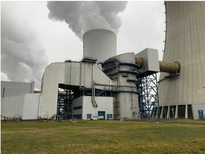
Rauchgasentschwefelungsanlage Block R des Kraftwerks Boxberg, Ansicht von Osten Fotograf/Urheber: Nora Wiedemann
