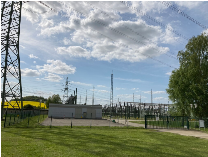
Umspannwerk Schmölln, Ansicht von Osten Fotograf/Urheber: Kathrin Kruner
