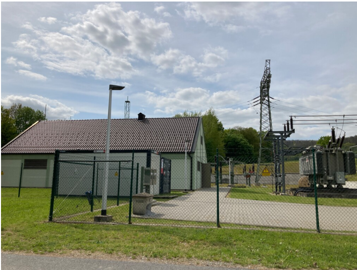
Umspannwerk Rodewitz/Spree, Ansicht von Südosten Fotograf/Urheber: Kathrin Kruner
