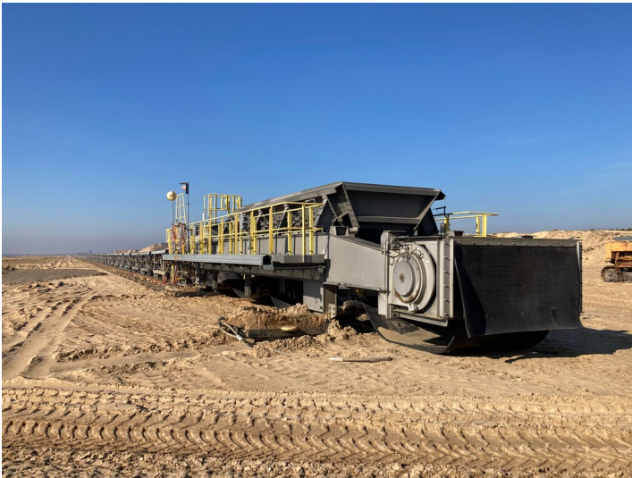
Abraumbandanlage des Tagebaus Reichwalde aus mehreren Einzelbändern und Bandantriebsstationen Fotograf/Urheber: Kathrin Kruner
