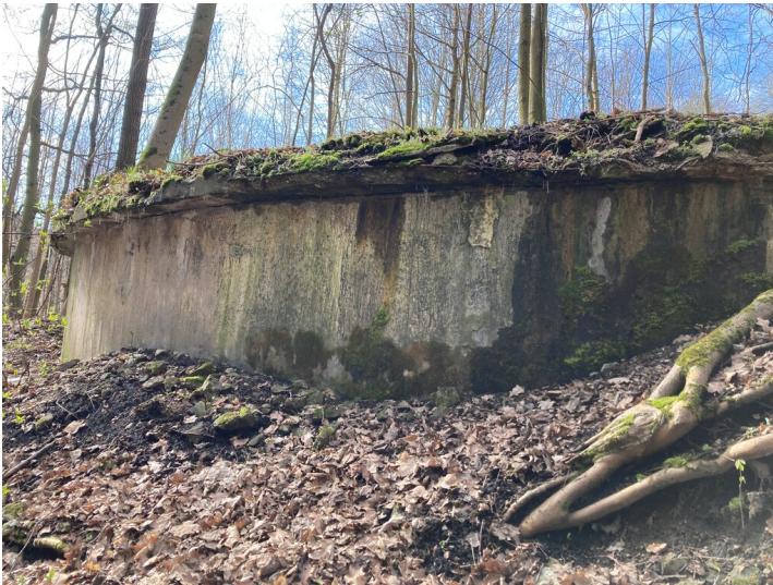
Reste der Anlage Jakob II zur Gewinnung von Flugbenzin, Ansicht Stahlbetonbehälter Fotograf/Urheber: Kathrin Kruner
