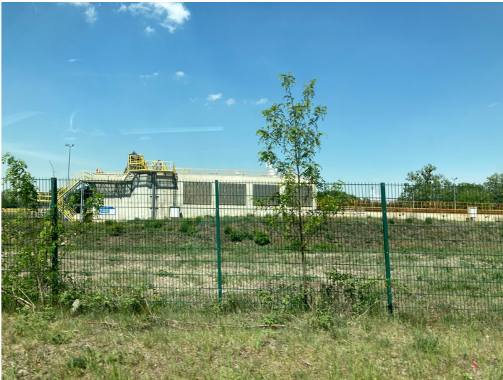
Grubenwasserbehandlungsanlage Schwarze Pumpe, Ansicht von Süden Fotograf/Urheber: Kathrin Kruner
