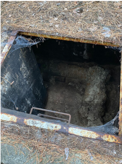
Schacht der unterirdischen Gasleitung vom Gaskombinat Schwarze Pumpe nach Hoyerswerda Fotograf/Urheber: Nora Wiedemann
