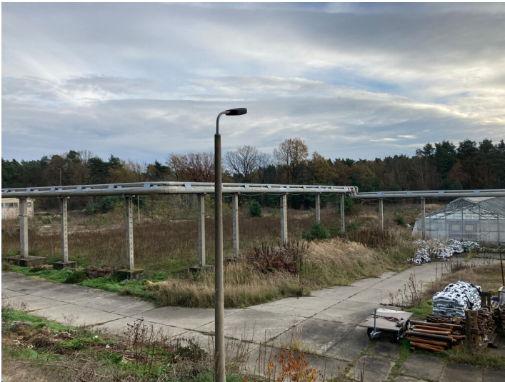
Fernwärmeleitung Boxberg Fotograf/Urheber: Matin Neubacher
