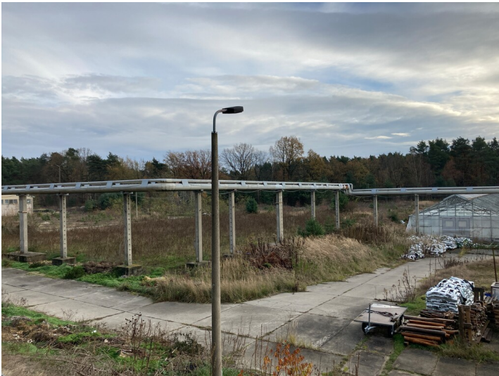
Fernwärmeleitung Boxberg Fotograf/Urheber: Matin Neubacher
