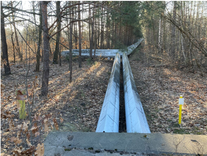
Fernwärmeleitung vom Kraftwerk Boxberg nach Weißwasser Fotograf/Urheber: Nora Wiedemann
