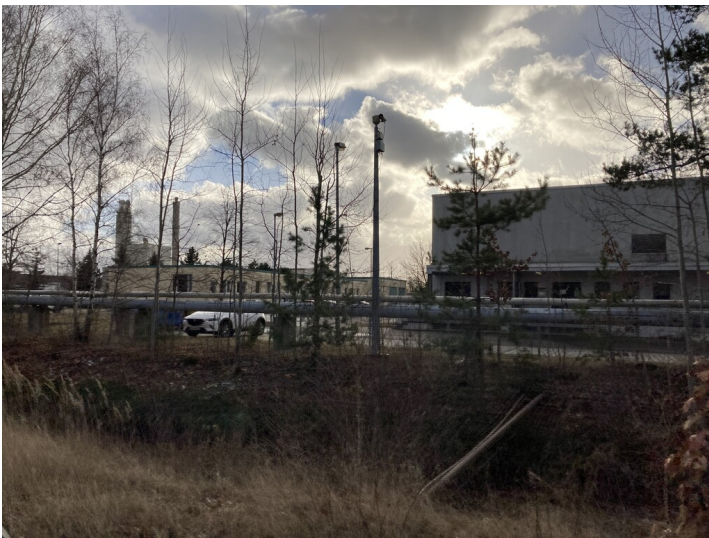
Großraumwasserkessel mit Braunkohlestaubbrenner Fotograf/Urheber: Nora Wiedemann
