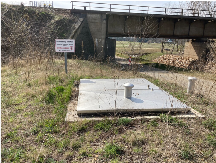
Überleitung des Nochtener Wassers in die Grubenwasserbehandlungsanlage Schwarze Pumpe Fotograf/Urheber: Nora Wiedemann
