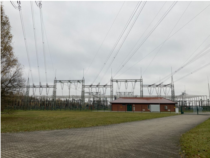
Umspannwerk Hagenwerder 380 kV Fotograf/Urheber: Nora Wiedemann
