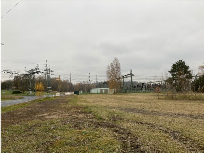
Umspannwerk Hagenwerder 110 kV Fotograf/Urheber: Nora Wiedemann
