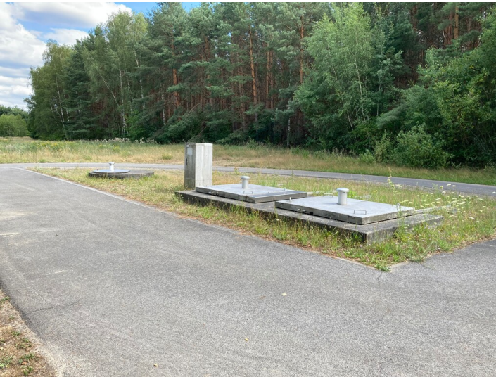
Ableitungssystem für das wiederansteigende Grundwasser Weststrandgraben Fotograf/Urheber: Nora Wiedemann
