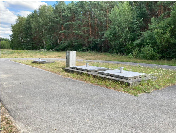
Ableitungssystem für das wiederansteigende Grundwasser Weststrandgraben Fotograf/Urheber: Nora Wiedemann
