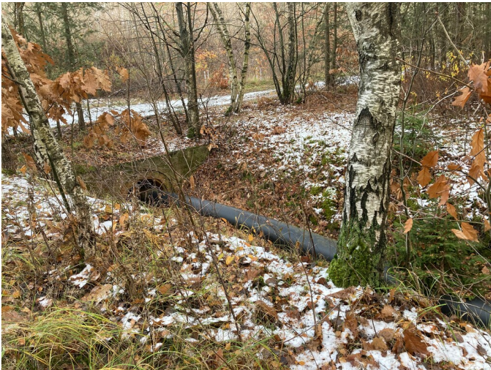
Grubenwassereinleitstelle in den Flößgraben Fotograf/Urheber: Nora Wiedemann
