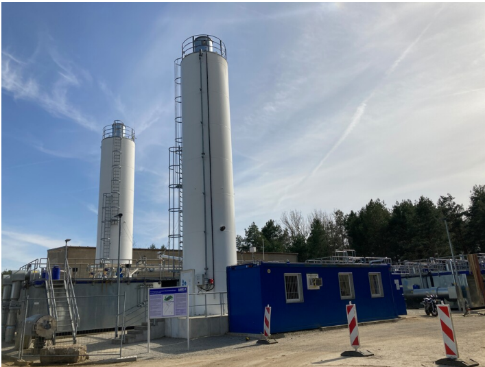
Modulare Wasseraufbereitungsanlage Burgneudorf Fotograf/Urheber: Matin Neubacher
