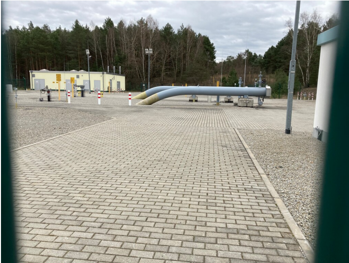
Molchschleuse Fotograf/Urheber: Nora Wiedemann
