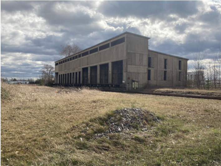
30 kV-Station Generatorenhaus Fotograf/Urheber: Nora Wiedemann
