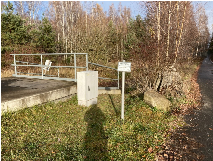
Klarwasserableiter Ost Fotograf/Urheber: Nora Wiedemann
