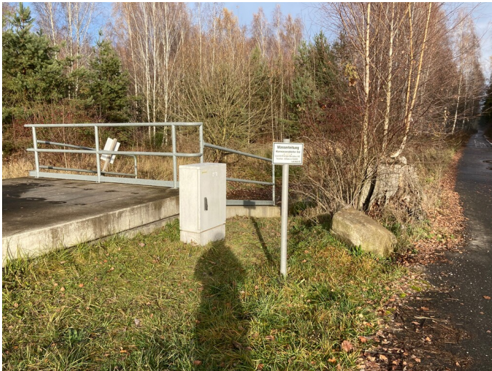
Klarwasserableiter Ost Fotograf/Urheber: Nora Wiedemann
