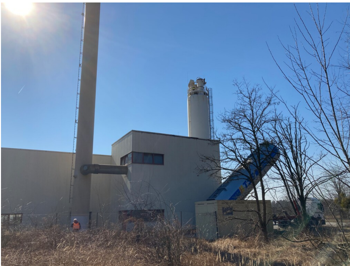
Großraumwasserkessel mit Kohlestaubfeuerung zur Fernwärmeversorgung Fotograf/Urheber: Nora Wiedemann
