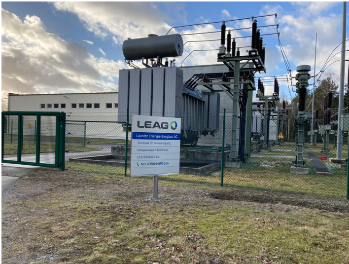
Umspannstation 110 kV auf Tagebauspannung Fotograf/Urheber: Matin Neubacher
