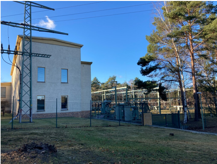
Umspannwerk Gablenz Fotograf/Urheber: Matin Neubacher
