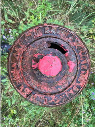
Hydrant der Werkssiedlung Werminghoff Fotograf/Urheber: Nora Wiedemann
