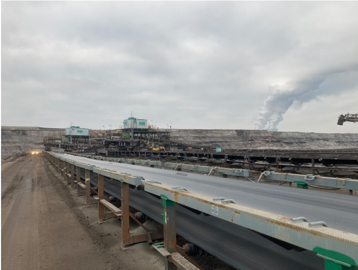
Antriebsstation mit Umlenkstation der Bandanlagen in Strosse 2 Fotograf/Urheber: Nils Schinker
