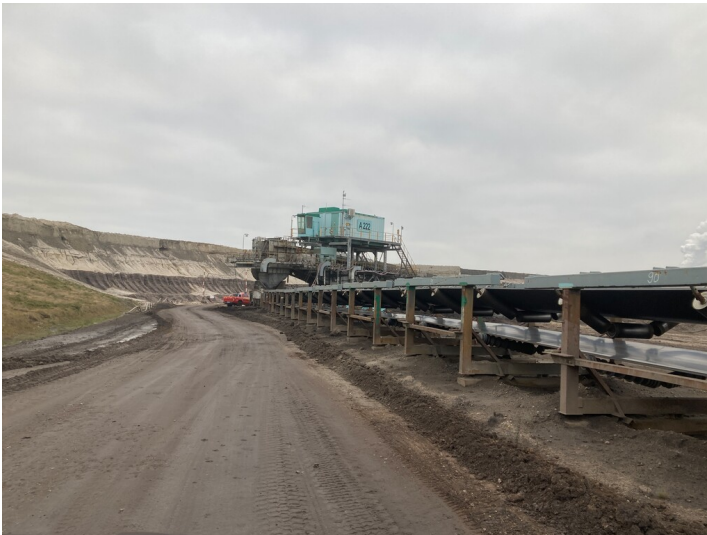
Rückbare Bandanlage, Blick zur Antriebstation Fotograf/Urheber: Nils Schinker
